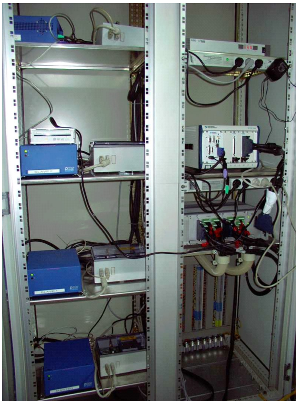
Bild 6.48: Das MIDR im Steuerschrank
