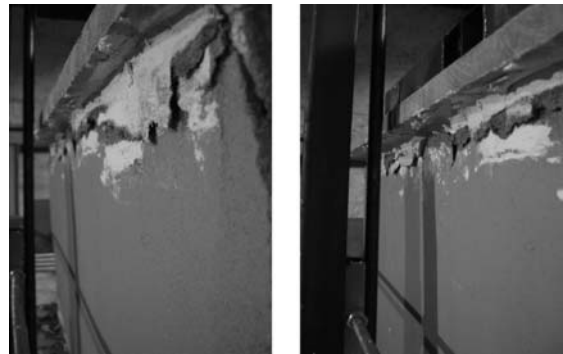
Abbildung 2.10: Bruch des Putzes bei Probe 1.5.7.2
